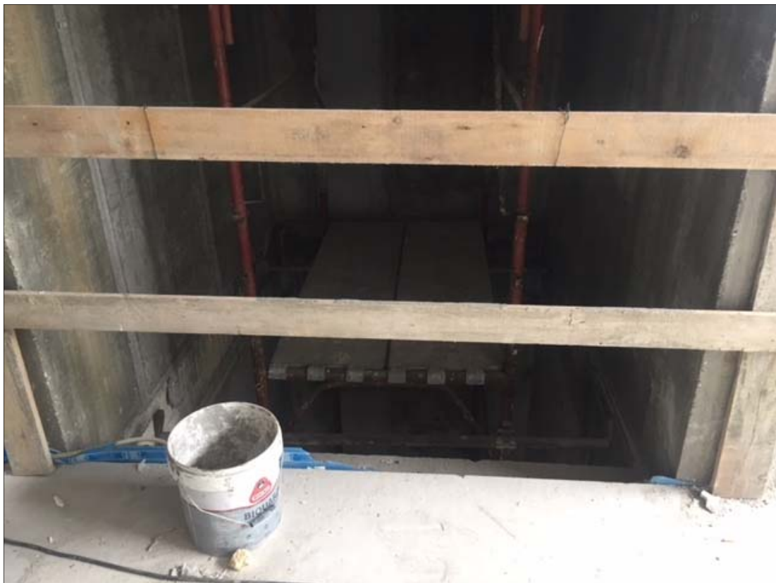
FOTO 2 – Vano corsa elevatore A: piano primo vista verso il basso
