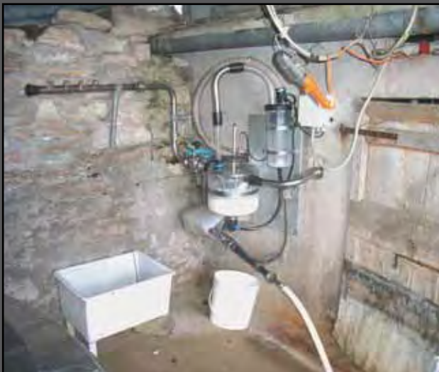
16. Verifica periodica parti meccaniche
