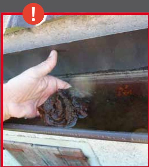
3. Grondaia con ristagno di acqua
