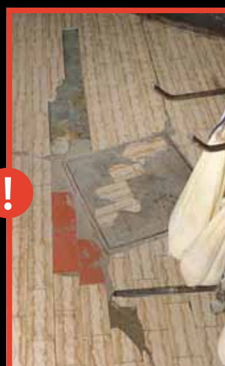
2. Pavimentazione da sistemare
